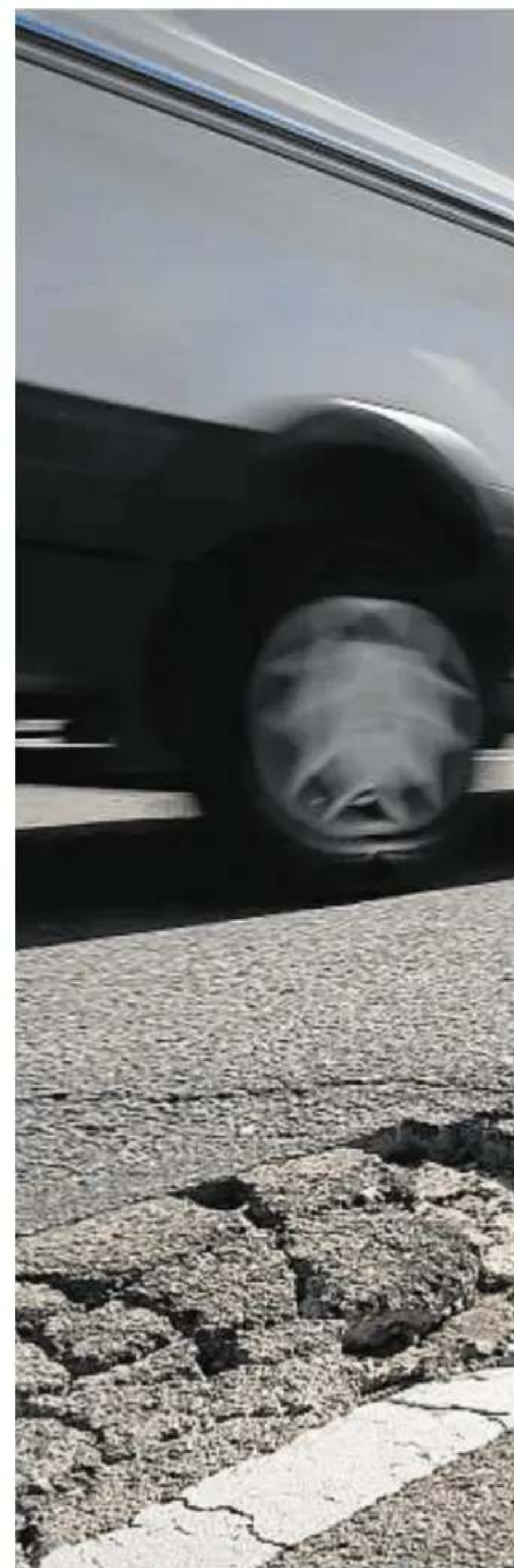
Socavón en la carretera tras el temporal. Matías Nieto
